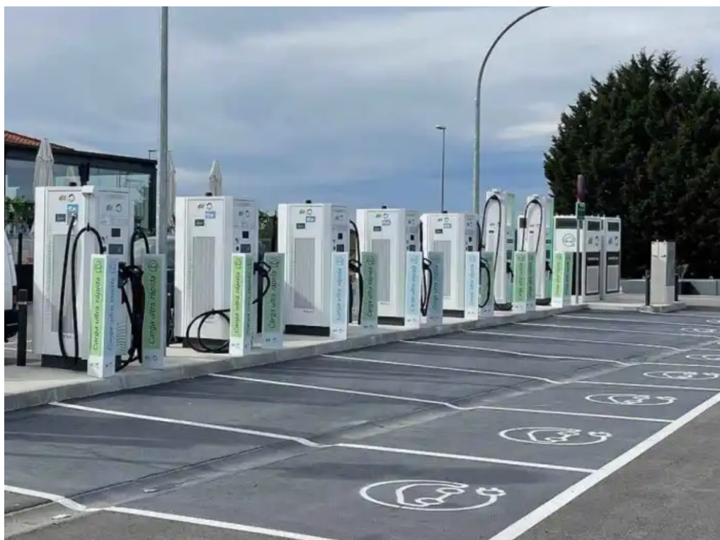
Postes de recarga de coches eléctricos
