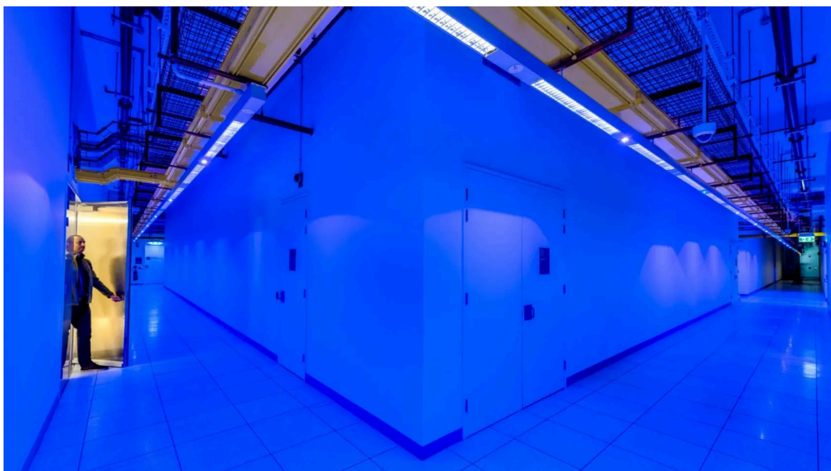
Interior de un centro de datos de Equinix.
