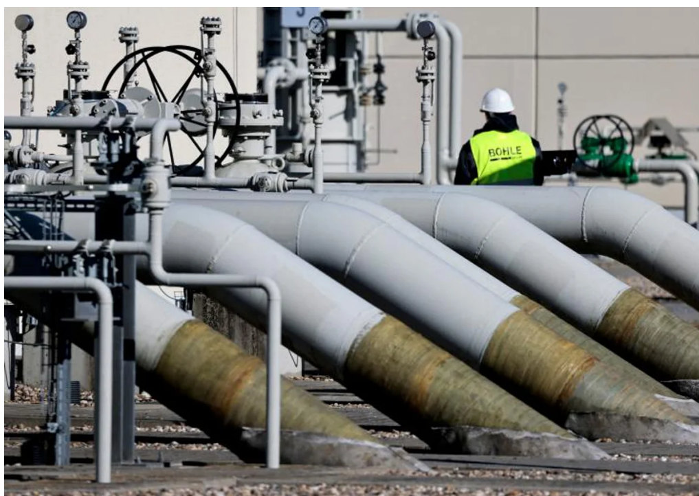
Gasoducto Nord Stream 1 REUTERS
