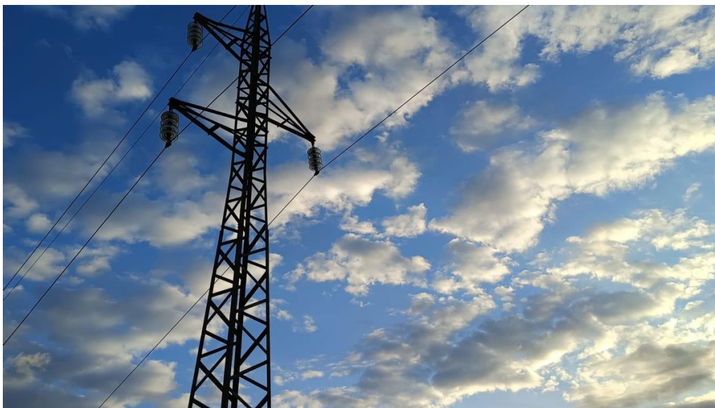
Torre de la red de distribución de electricidad. / D. P. P.
