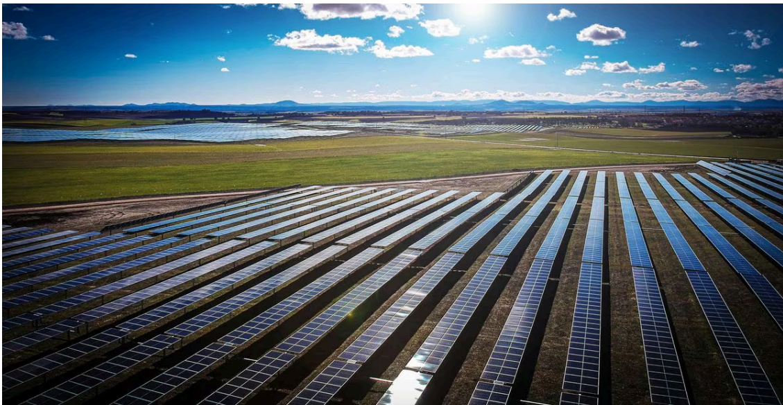
Vista aérea de un parque fotovoltaico en Torrijos (Toledo).
