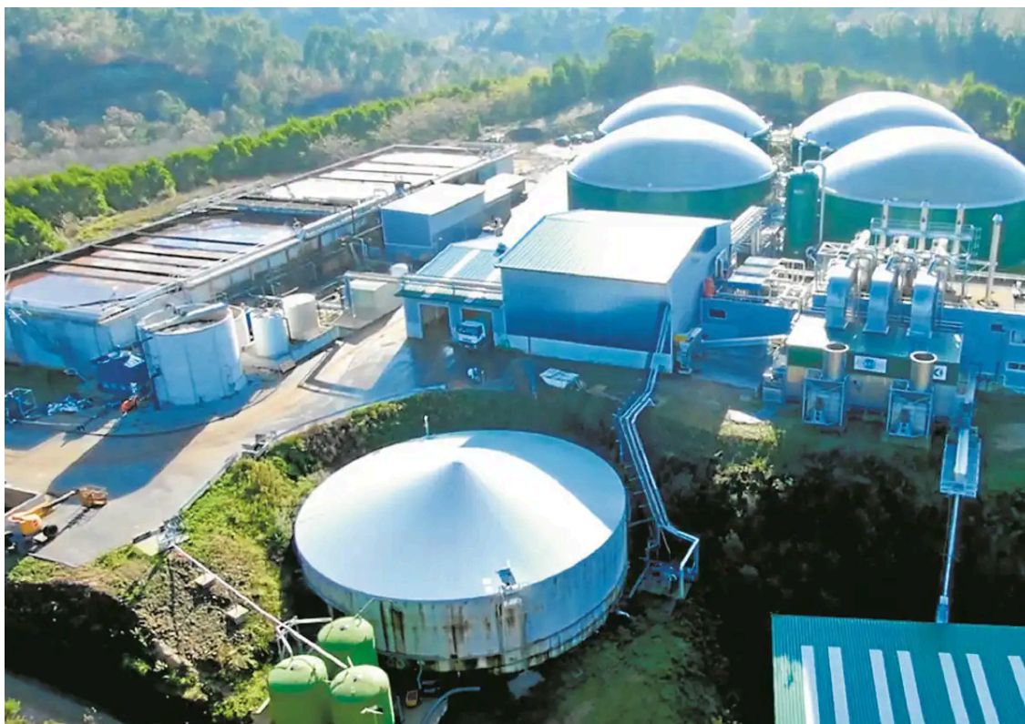
Una imagen de la estación de biogás de Navia (Asturias)
