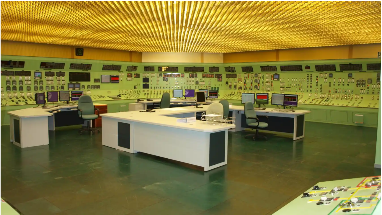
Sala de control de Almaraz. CNA
