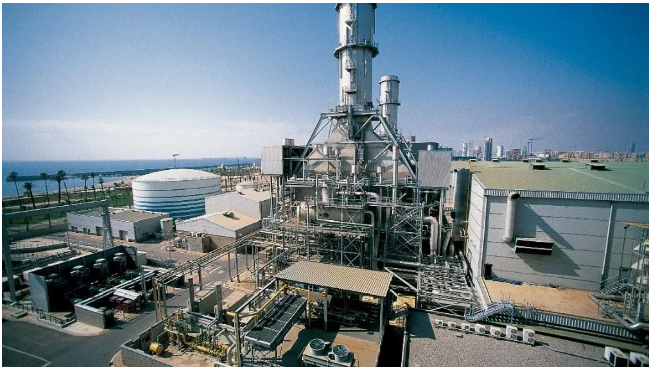
La central térmica de ciclo combinado de Sant Adrià de Besòs (Barcelona). Endesa
