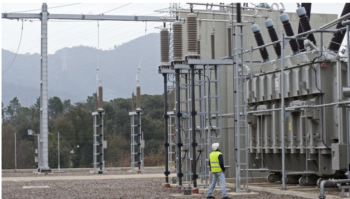
Foto de recurso de una subestación eléctrica. (EFE/Robin Townsend)
