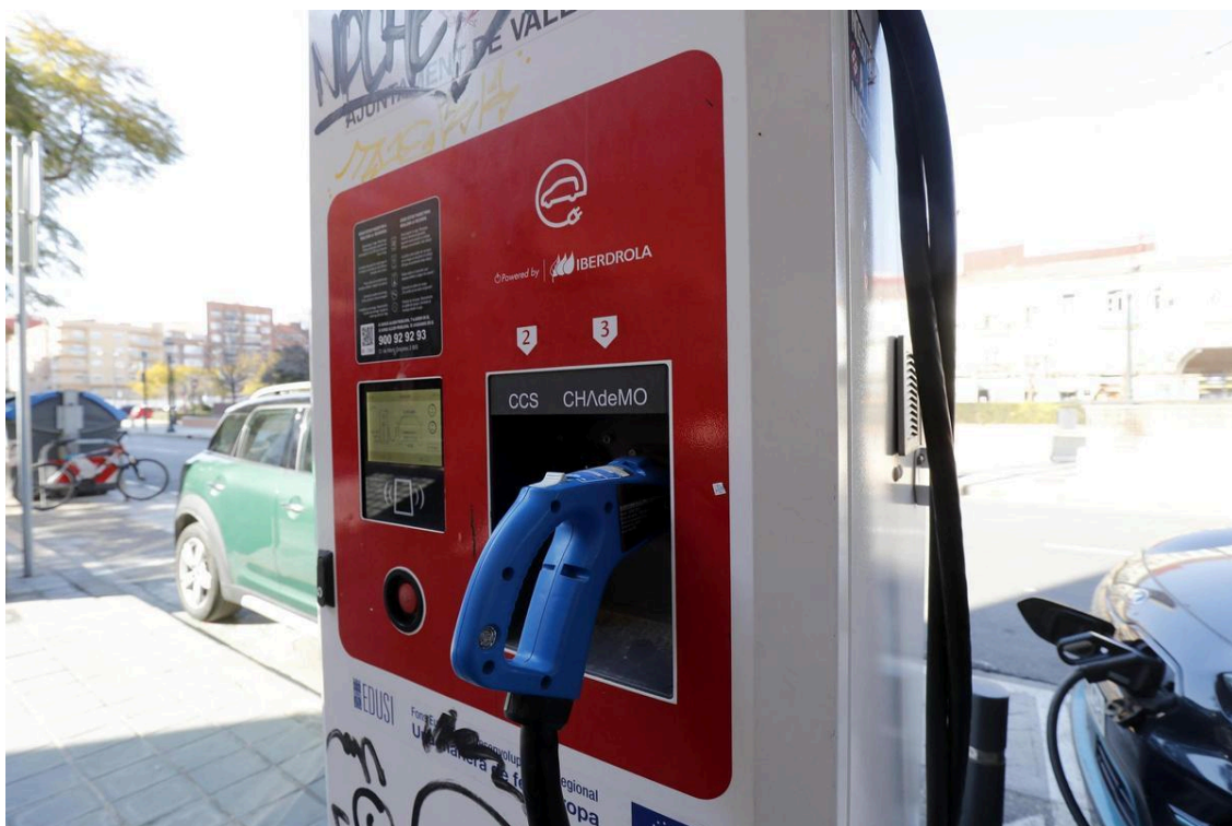
Puntos de recarga coches electricos en el mercado del Cabanyal. / Francisco Calabuig
